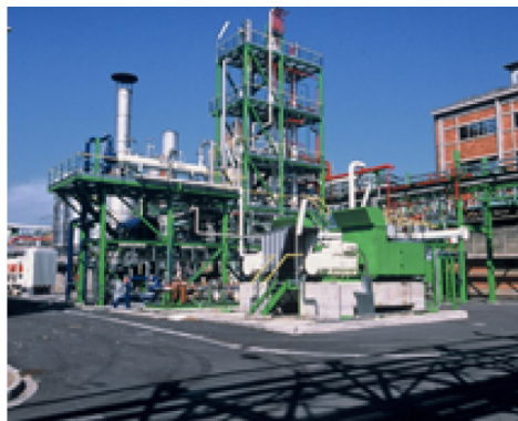
FIGURE 2 – Unité de production d'ammoniac
